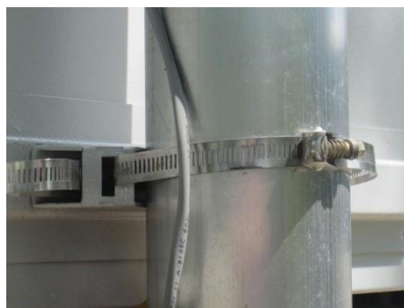
Figura 5 – Radar sujetado en poste usando Soporte Estándar
